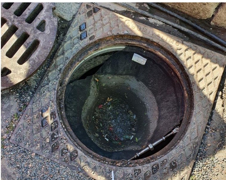
Kuva 1. Filtro-hulevesisuodatin asennettuna tutkimuskaivoon.
